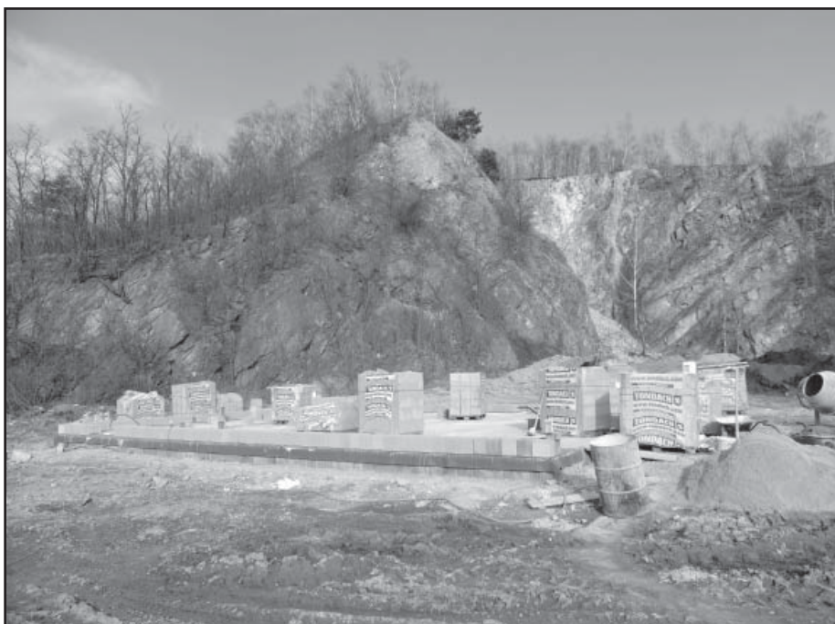
Stavební práce na výstavbě hasičárny byly skutečně zahájeny v měsíci únoru, a to výstavbou vodovodní, dešťové a kanalizační přípojky. V průběhu března byly zhotoveny základy a začala stavba obvodové zdi.
